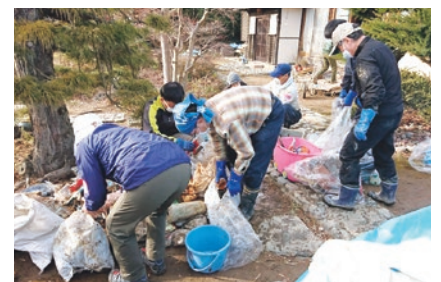
令和元年東日本台風での、ボランティアによる浸水家屋の片付けの様子
